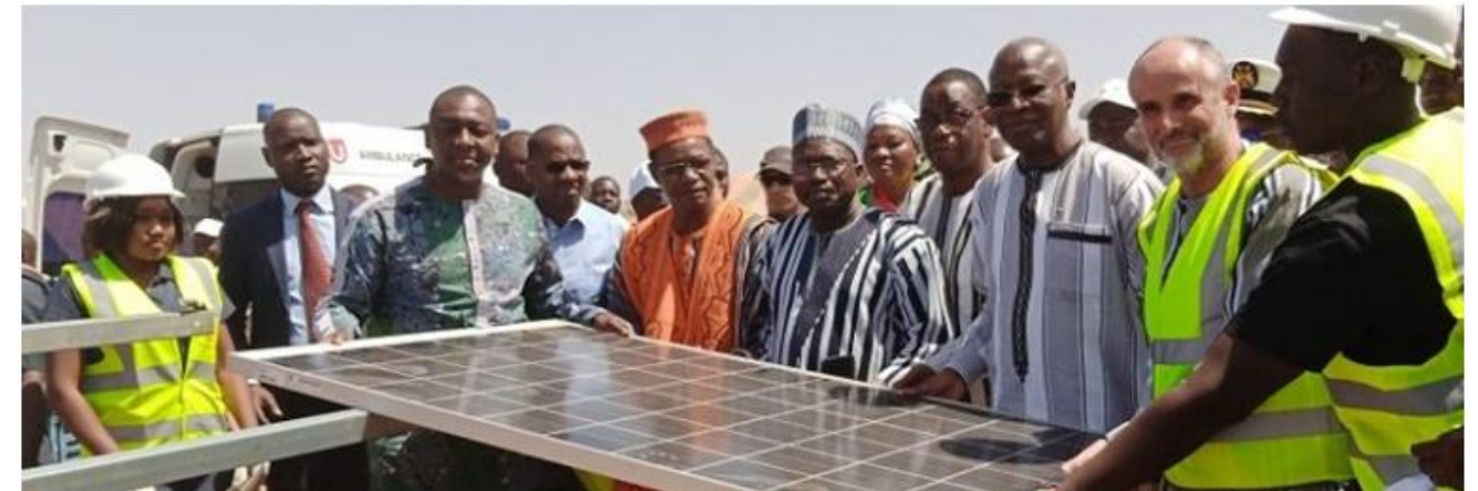
Figure 15 : Pose du 1 er panneau de la centrale solaire de Pâ – Burkina Faso – Février 2022 (source : URBASOLAR, 2022)
